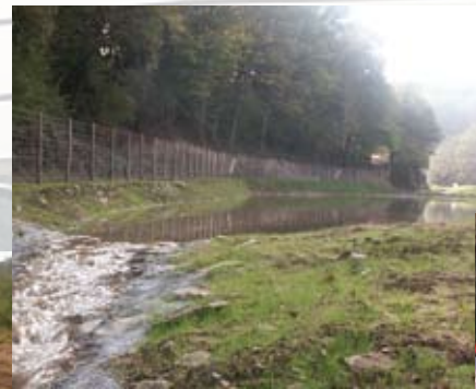
Vue depuis la sortie du 1 er bassin de décantation, avec la surverse vers le 2 ème
